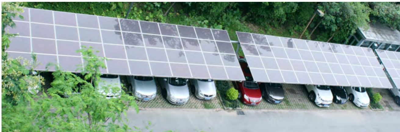
太阳能车棚发电系统运行测试及数据采集
