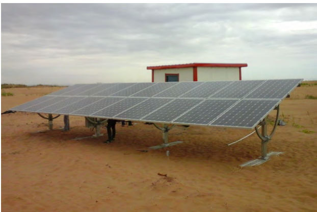
内蒙古乌兰布和沙漠光伏提水综合治理项目 (2013年)
